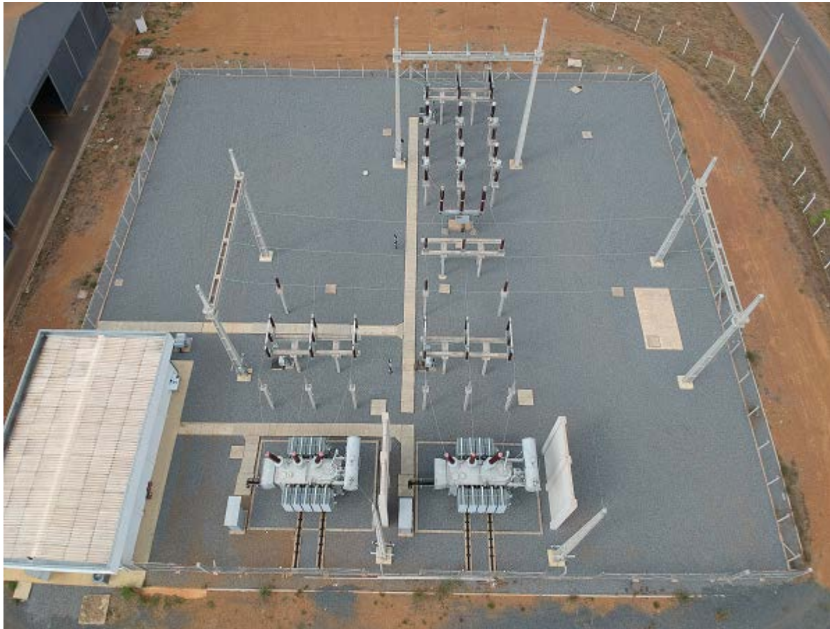
Figura 1 – Vista superior da instalação da subestação
