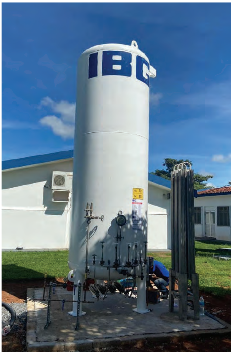
BASE TANQUE DE OXIGÊNIO INSTALADO FONTE: AUTOR
