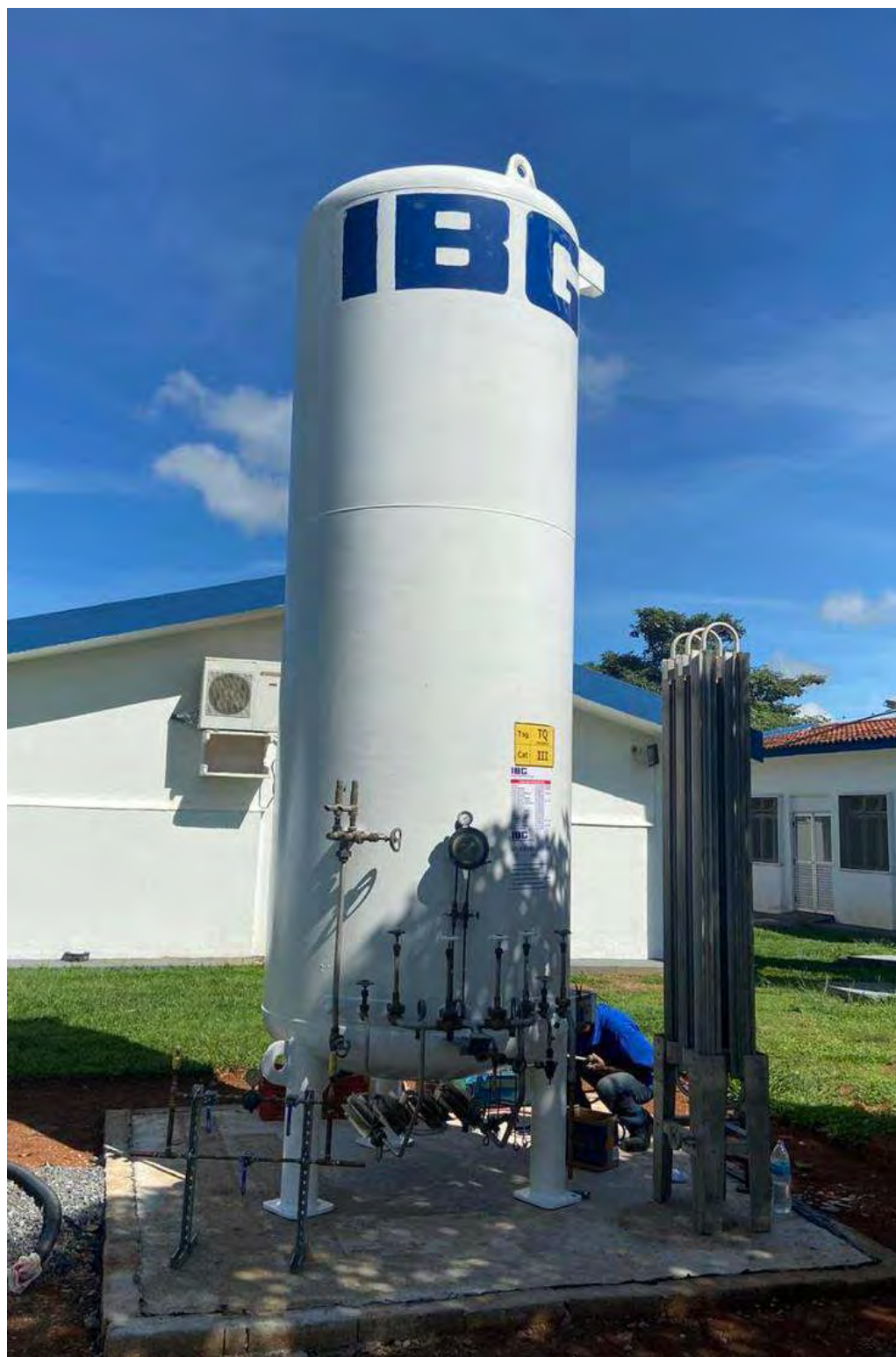
Base Tanque de oxigênio Instalado
