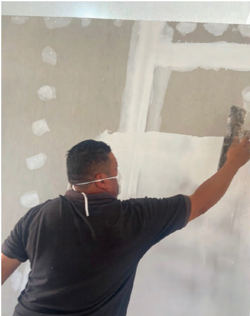
PREPARO PARA PINTURA DIVISÓRIA CONSULTÓRIO OBSTÉTRICO E SALA DE EXAMES FONTE: AUTOR
